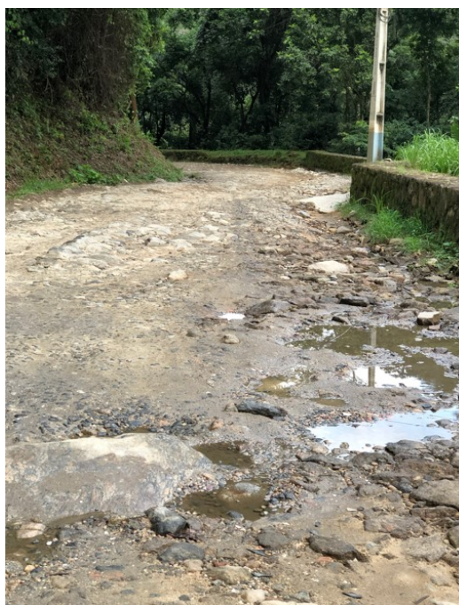
Figura 40 - Estrada Imperial de Pedra de Pé Moleque danificada pelas chuvas Fonte: arquivo da autora, 2021.
