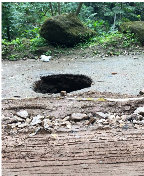
Figura 42 - Trecho da estrada com desabamento Fonte: arquivo da autora, 2022.
