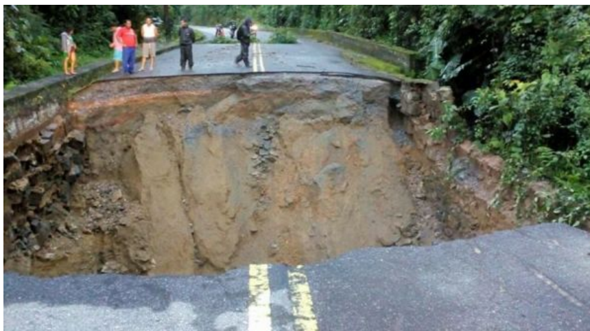
Figura 34 - Trecho da RJ-14 que desabou com as fortes chuvas
