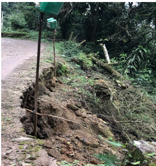
Figura 41 - Trecho da estrada danificada pela chuva Fonte: arquivo da autora, 2022.
